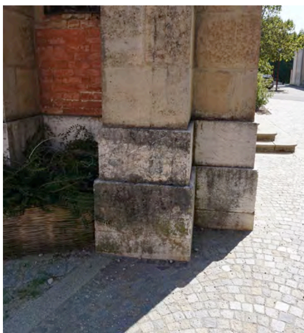
Détail de l'encrassement des soubassements en pierre
