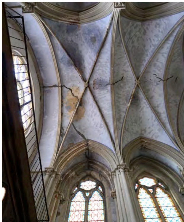
Traces de fissures colmatées sur les voûtes
