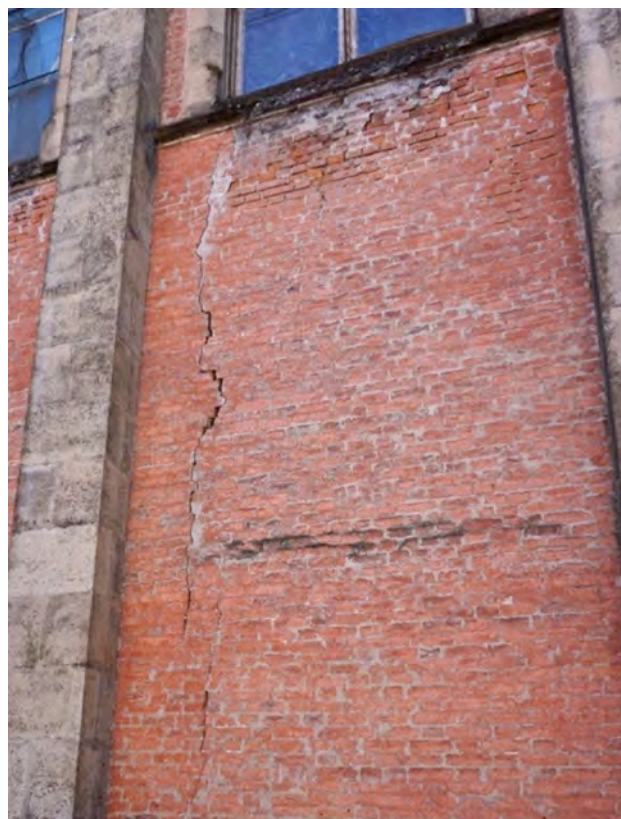
Fissure sur le « remplissage » en brique de l'élévation Ouest
