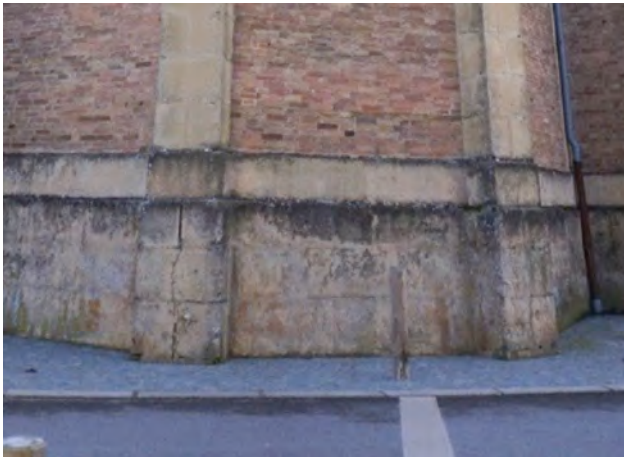
Fissure verticales sur les soubassements des contreforts
