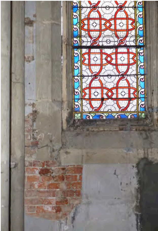
Détail des fissures sur les voûtes en briques
