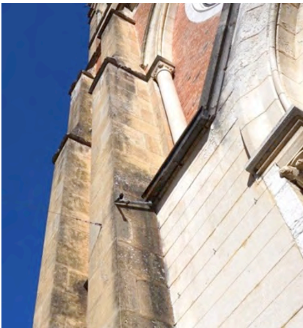
Détail du niveau d'encrassement des éléments en ciment moulé
