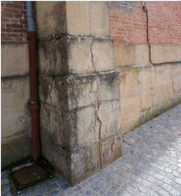
Détail des fissures en pieds de contrefort
