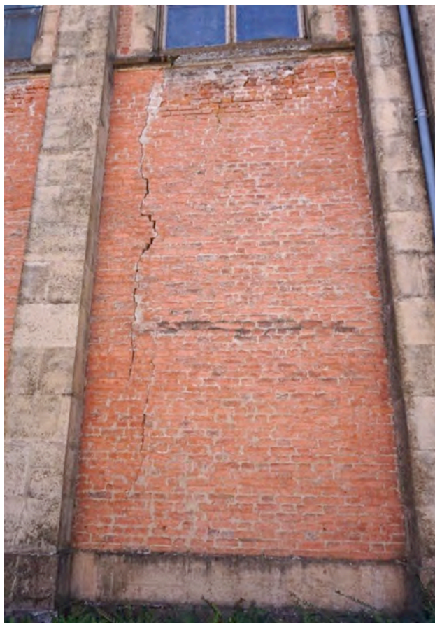
Détail d'une fissure traversante sur l'élévation Ouest
