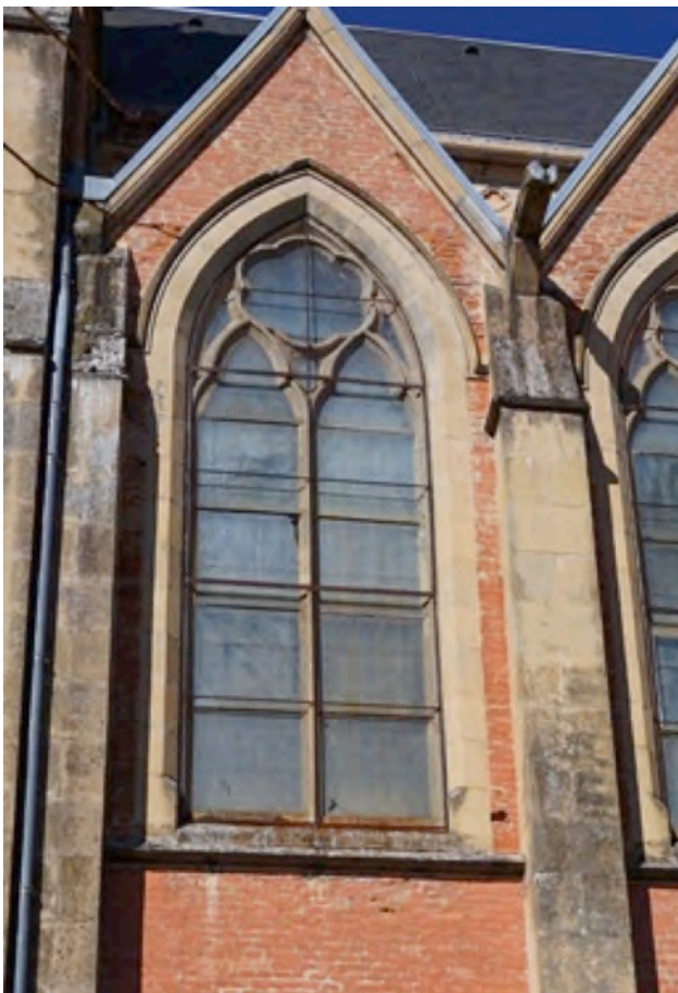
Grille de protection extérieure des vitraux rouillée
