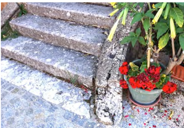
Détail de l'état de l'embranchement de la porte latérale Ouest
