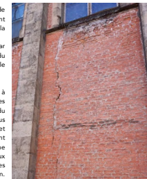
Fissure sur la « remplissage » en brique de l'élévation Ouest
